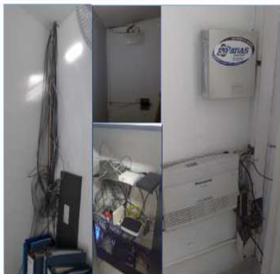
Proyecto Cableado Estructurado Oficinas – Recepción - Auditorio
