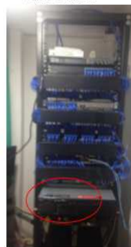
CENTRALIZACION EN Data Center
